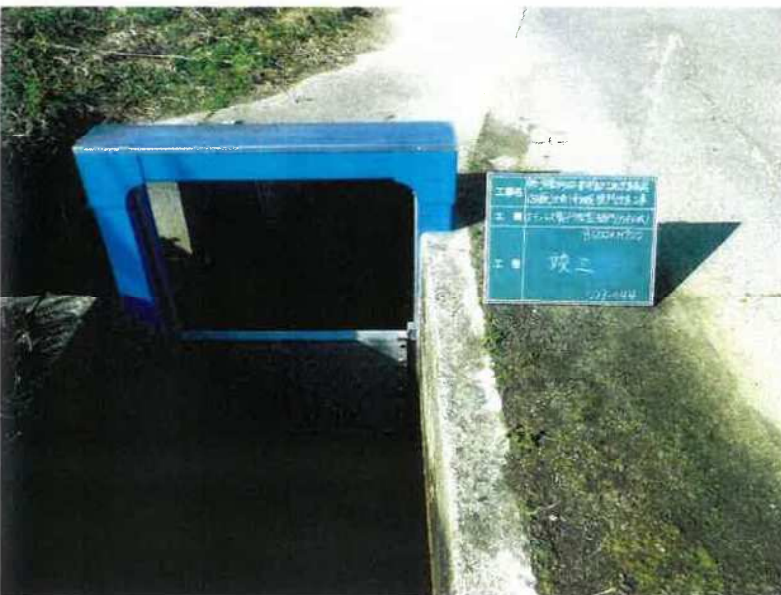
ステンレス製門柱型樋門
