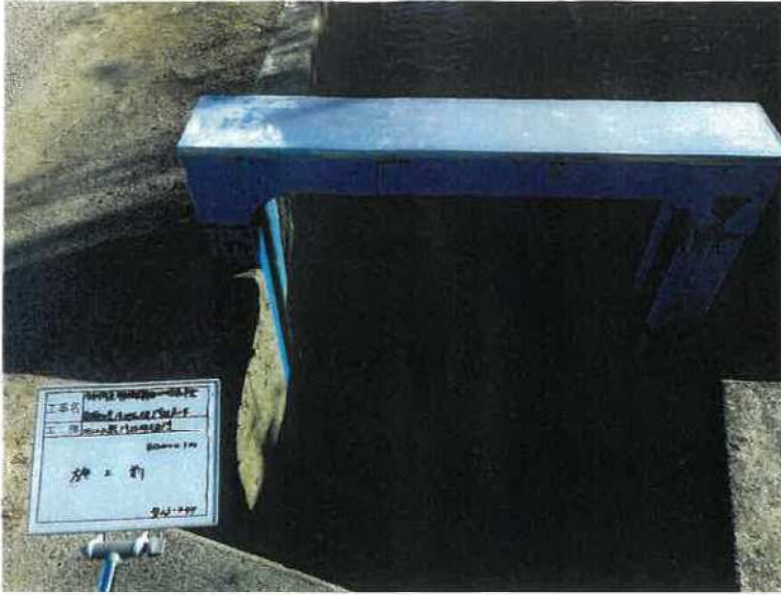
ステンレス製門柱型樋門
