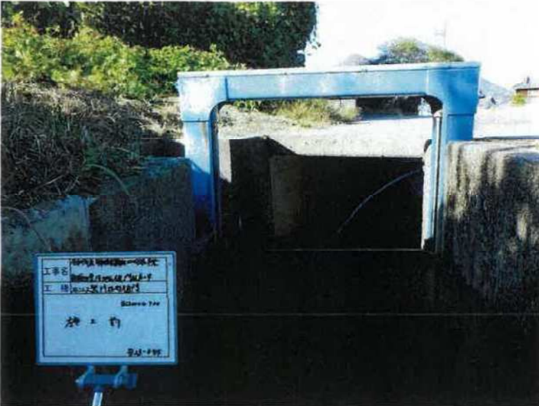
ステンレス製門柱型樋門
