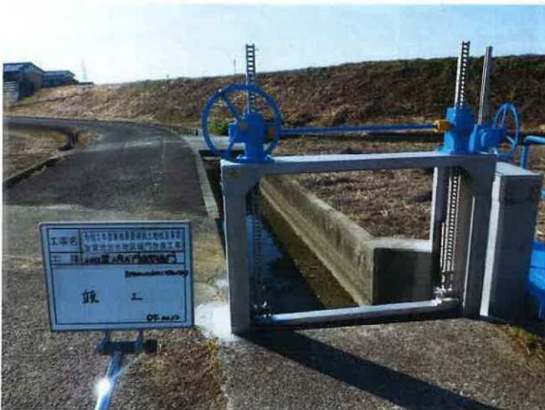
本線 ステンレス製二段式門柱型樋 門
