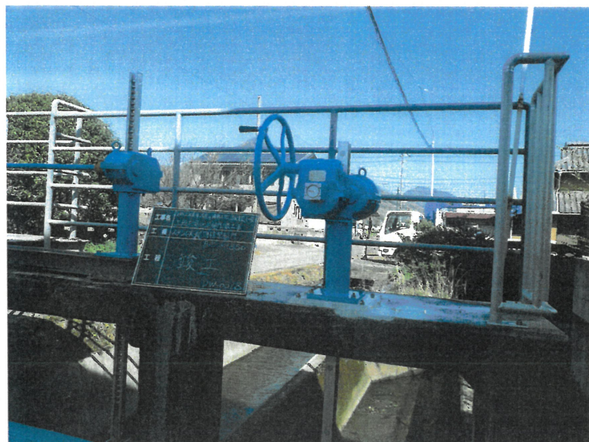
ステンレス製門柱型樋門
