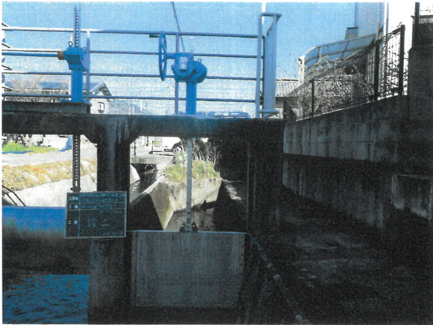
ステンレス製門柱型樋門
