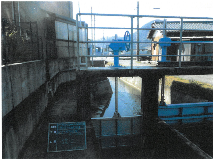
ステンレス製門柱型樋門
